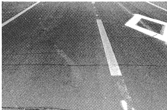
写真—1. 舗装を横断するクラック、センターのジョイントが目地切れを起していない場合（まだ完全に横断に至らないクラックも見える）
