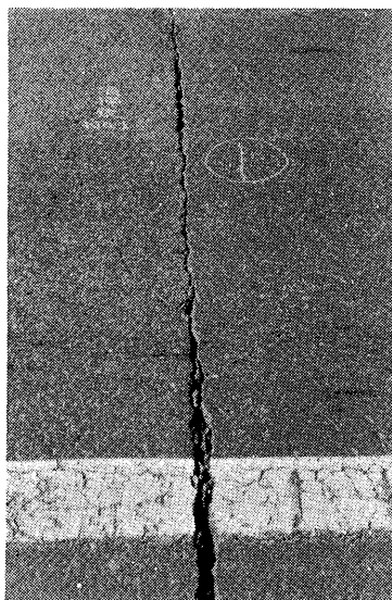
写真—3 大きく開いたクラック、20～30mmに達することもある。わだち部分は多少クラック巾が狭い。
