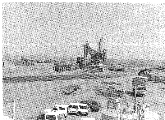
写真-2 アスファルトプラント
