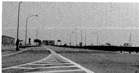
写真-2 橋梁の取付け部に生じた段差
