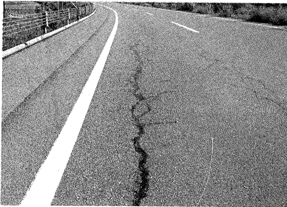
写真－3 わだち部に発生した縦ひび割れ
