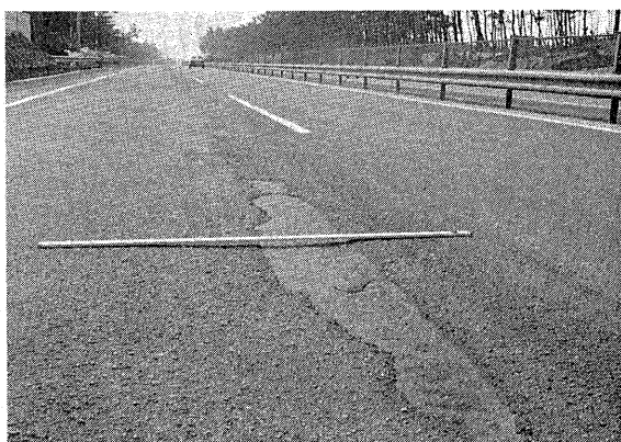
写真-6 路上表層再生工法の失敗の例 (新材厚が不足したためと思われる)
