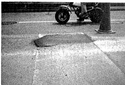
① 交通荷重により押し出された状態
