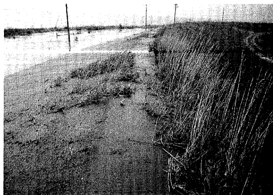
写真二 干拓堤防の法面舗装破壊(初期)
