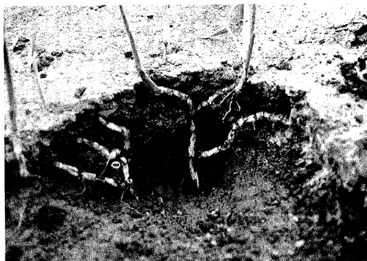
写真一 ヨシによるアスコン舗装破壊の状況
