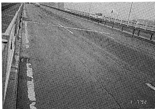
写真-3 主桁腹板直上の舗装のひびわれ
