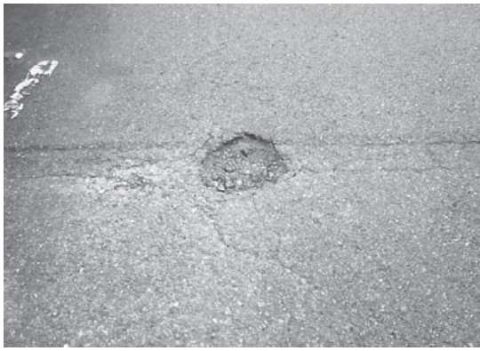
写真－１ ポットホール
