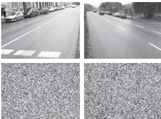
図－7 施工12年後の添加材別のSMA舗装路面 (左) 消石灰 (右) 脂肪酸アミン
