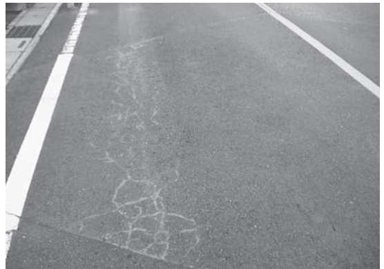
写真－４ 破損したパッチング（噴泥有り）
