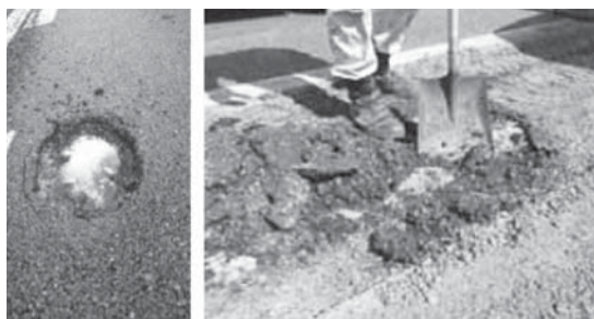
写真-1 高性能防水上の舗装損傷 1)
