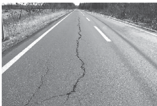
写真－３ 凍上ひび割れ
