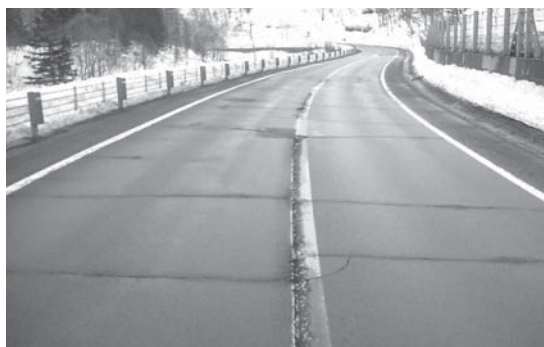
写真－2 低温ひび割れ
