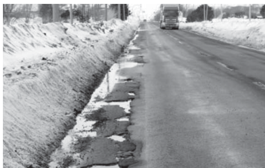
写真－1 融雪期に発生したポットホール
