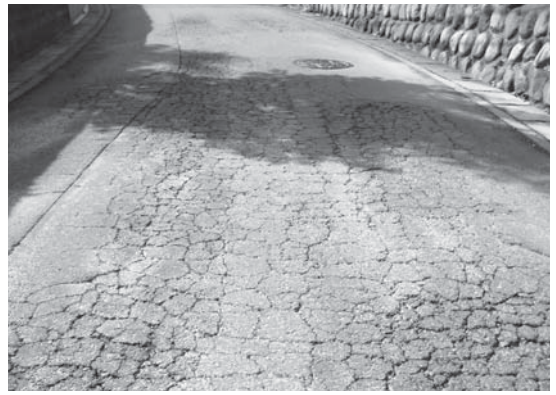
写真－２ 亀甲状ひび割れ
