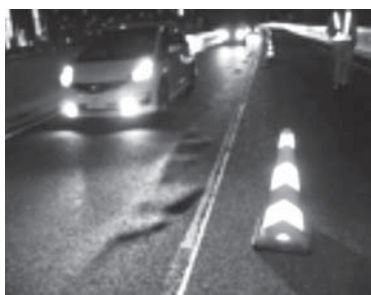
写真-2 鋼床版部の流動わだち掘れ
