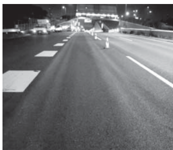
写真-3 高速湾岸線台場付近にできた沈降わだち掘れ
