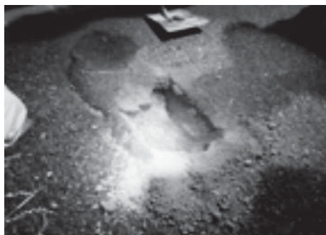
写真-1 路面にできたポットホールの事例
