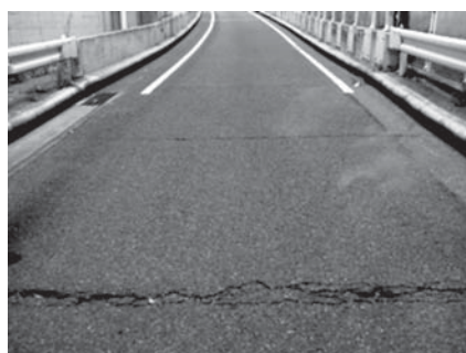
写真-5 踏掛版の前後に入った横断ひび割れ
