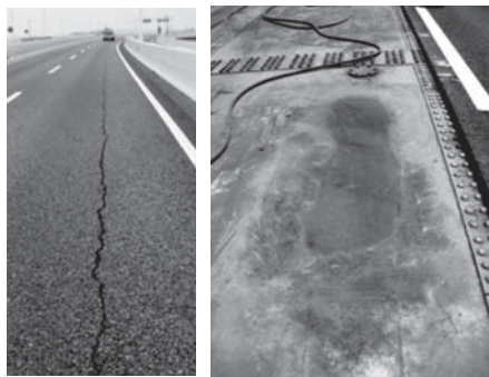
写真-4 縦断ひび割れ(左)と鋼床版上面の腐食(右)
