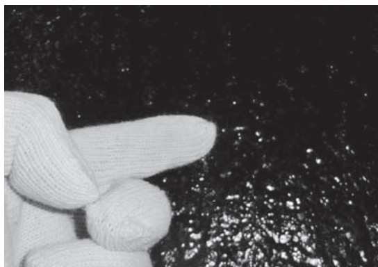
写真-1 タックコートの分解状況
