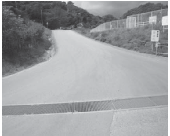
写真-4 施工後2年が経過した路面の状況
