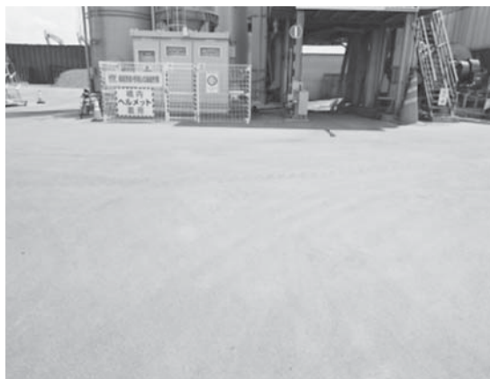
写真－2 施工後3年が経過した路面の状況
