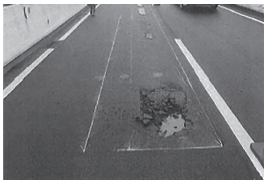
写真－1 基層厚 30mm以下の場所での損傷事例
