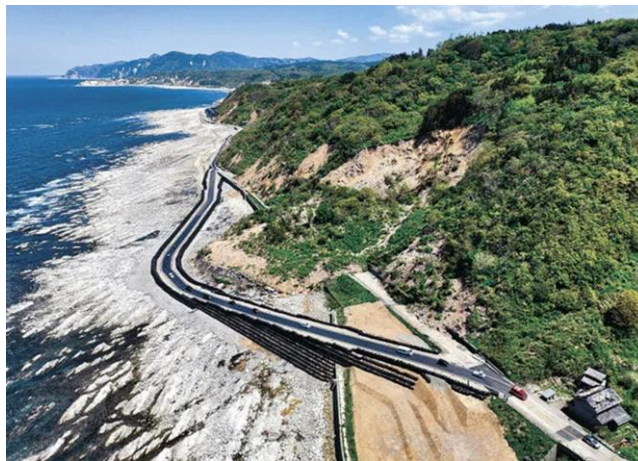
5月に開通した国道249号千枚田 付近の復旧う回路（石川県輪島市）
